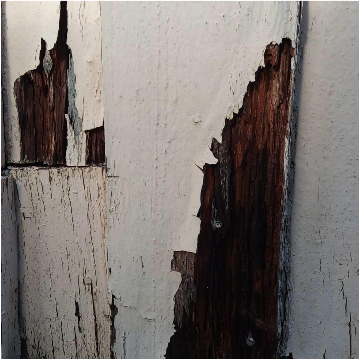
Figur 3. Modern träfasad underhållen efter ett fåtal år, enligt boende i fastigheten uppsatt tidigt 2000-tal. Fastigheten kommer snart att byta panel för andra gången under sin fyrtioåriga levnadstid. Foto Ebba Gyllenhak 2021 03 20.
